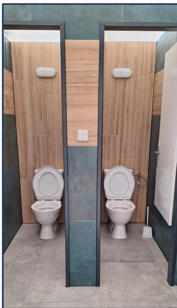
Obrázky č. 2 a 3 – Sociální zařízení žáků ve III. NP budovy školy po provedené opravě
